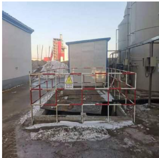
废气处理废水收集池
