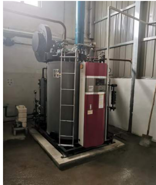
燃气供暖锅炉
