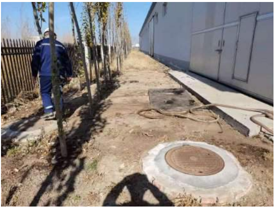
化粪池、隔油池
